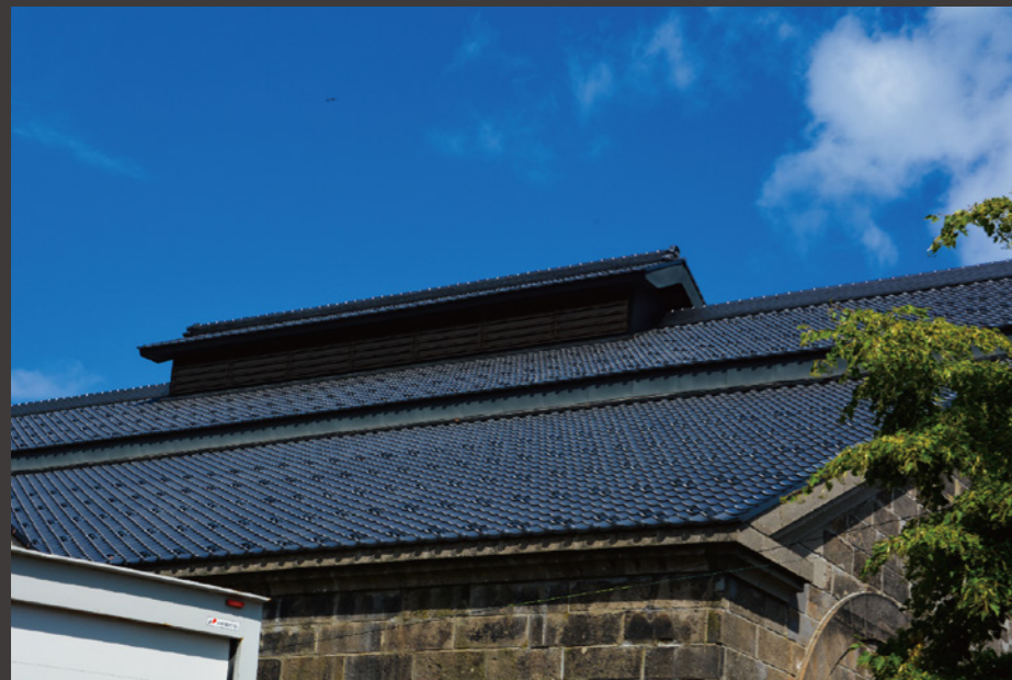
建設当時は瓦屋根だったが鉄板屋根に改装されていた。その後、屋根の一部が抜け落ちるなど老朽化が進み、平成7年3月の突風で一部が倒壊。同8年に約2万枚の瓦屋根の復元工事が実施された。
