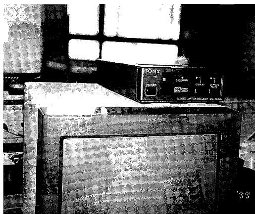
MH1・2に設置されているデコーダーシステム
